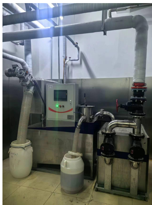
隔油池改造后
